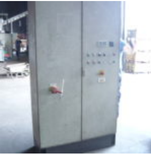
Szafa sterująca gotowa do transportu
