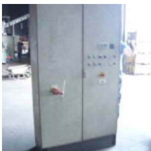
Szafa sterująca gotowa do transportu
