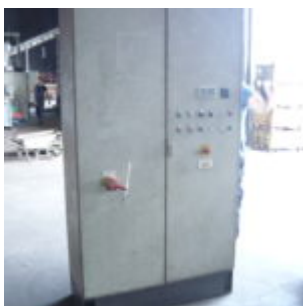
Szafa sterująca gotowa do transportu
