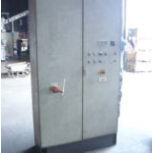
Szafa sterująca gotowa do transportu
