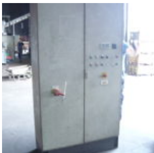
Szafa sterująca gotowa do transportu
